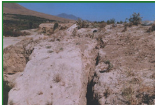
دیواره آبراهه در حال واژگونی بعثت نداشتن پوشش بیولوژیک در دیواره و آبشویی پایه آن
