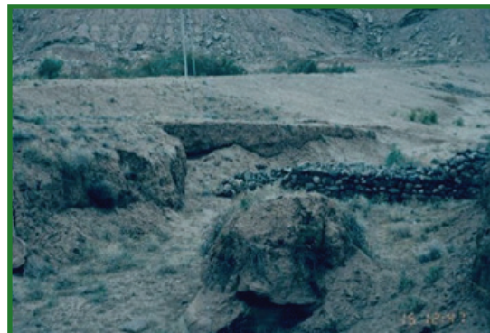
خندق ایجاد شده در اثر تخریب سازه‌های نامناسب
