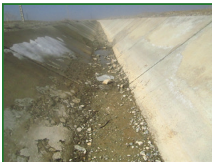
تأثیر یخبندان در تخریب پوشش بتنی
